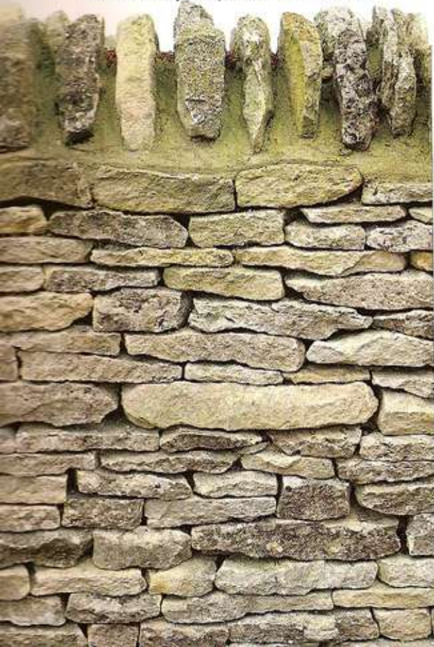
Стена, выложенная ровными рядами из сухого известняка. Верхний ряд посажен на раствор
